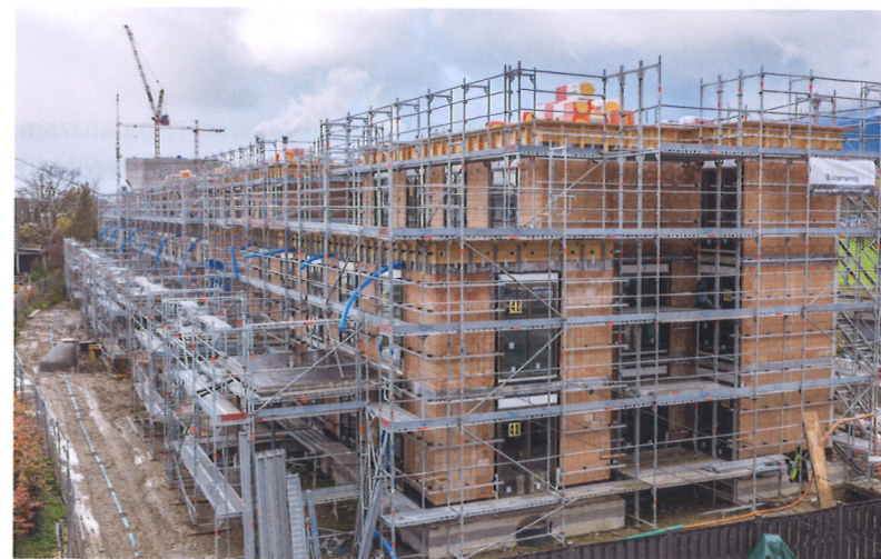
Ansicht aller drei Mehrfamilienhäuser im Rohbau während der Montage der primären Fassadenunterkonstruktion.
