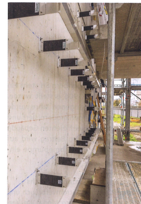
Primär Unterkonstruktion mittels wärmebrückenfreien Konsolen von Saint-Gobain Weber AG.
